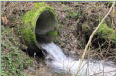
Verrohrungen: Unüberwindbar für Bachorganismen
